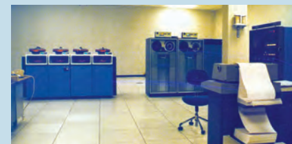
c. 1969. Instalacións informáticas da Caixa de Aforros de Santiago
